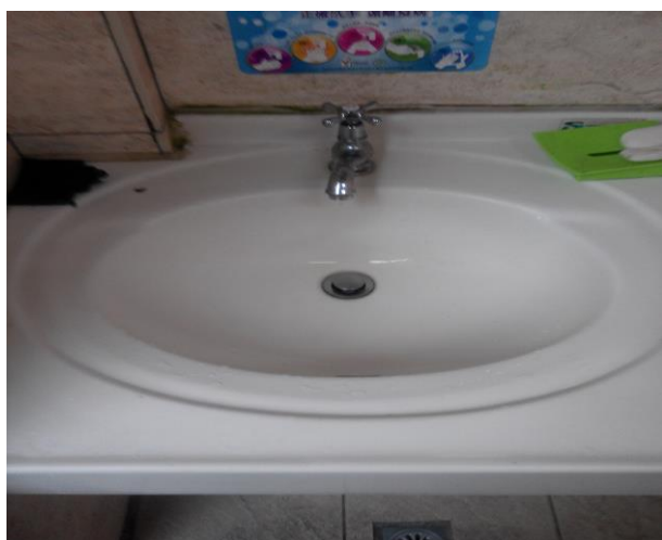
行政大樓廁所洗手槽
