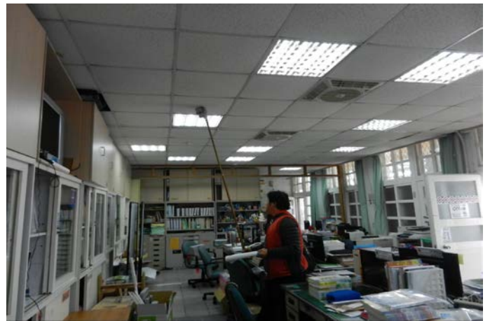
濃煙偵測器檢查
