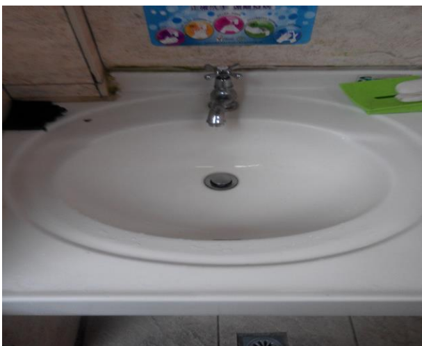
行政大樓廁所洗手槽
